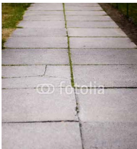
Moos auf Wegen kann bei Nässe zur Rutschgefahr werden
